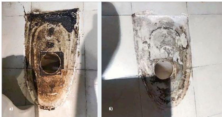
❖ Фото 1. Канализационная труба в полу без фланца под унитазом в отделанном номере 8326 с признаками протечки и негерметичного соединения (а). След от неровно установленного унитаза в номере 8623 гостиницы «Динис» (б)
