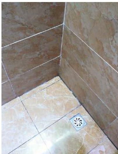
⌘ Фото 2. Типичный пол в душевой комнате в отеле в Шанхае, где на слив не установлен сифон
