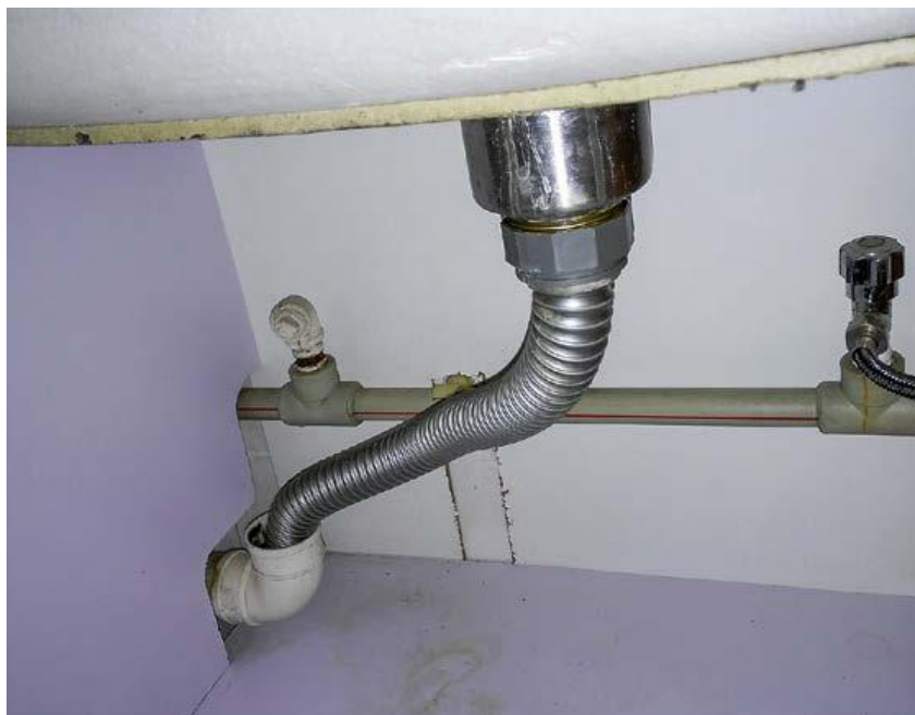
⌘ Фото 3. Гибкая сливная труба кухонной мойки без сифона, входящая в канализационную трубу без герметичного соединения, в типичной квартире в Пекине — китайской столице
